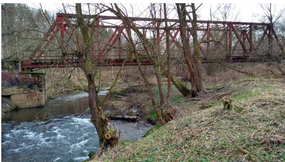
Most nad Kaczawą z wodą podmywającą podmurówkę
